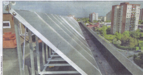
Dům č. 28 v ulici Láněšova na Barrandově má na střeše 38 stavebních kolektorů.
